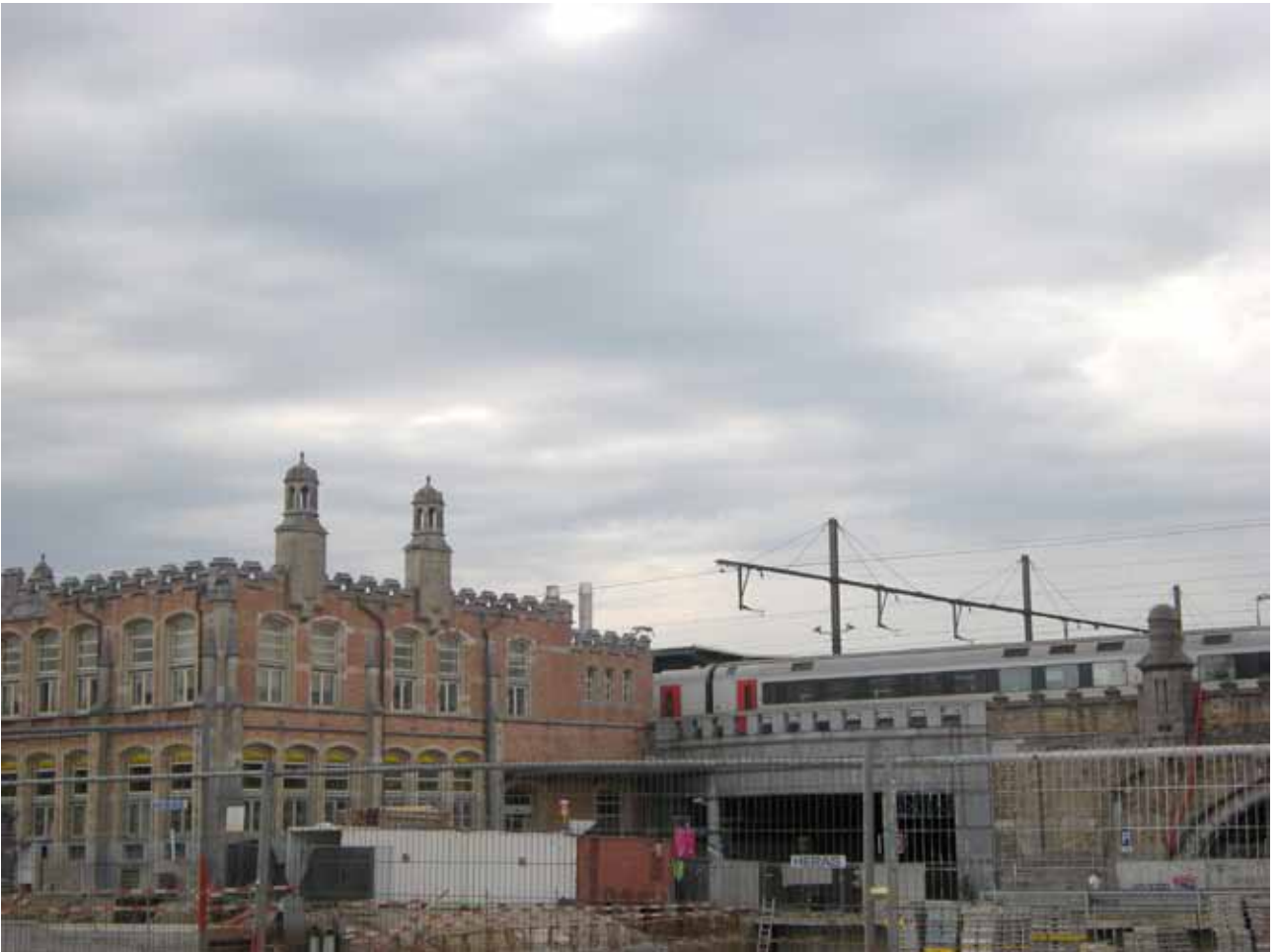
Un des aménagements de la Ville de Gand - le projet «Gand-Saint-Pierre» proposera une gare améliorée multimodale pour accueillir davantage de voyageurs
